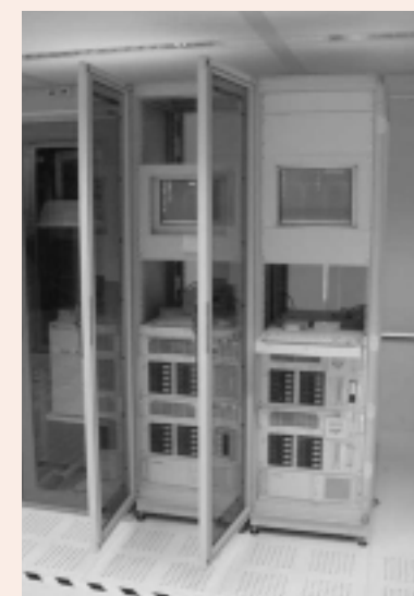
Het datacenter van C/TAC-Align is uitstekend ingericht voor de verschillende manieren van hosting.
